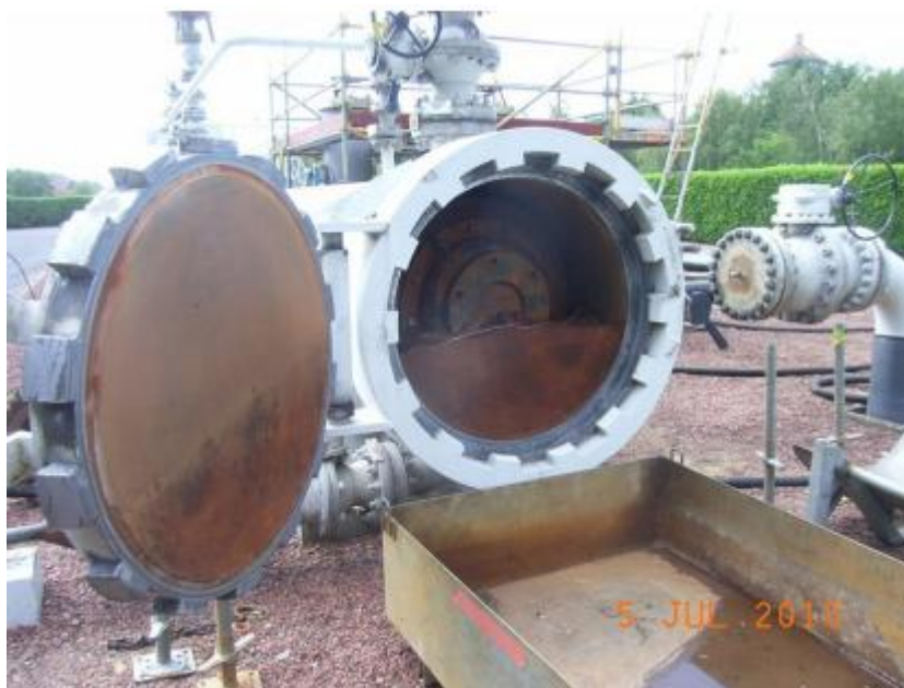
Figuur 5-20: Voorbeeld pigging ontvangststation (2)
