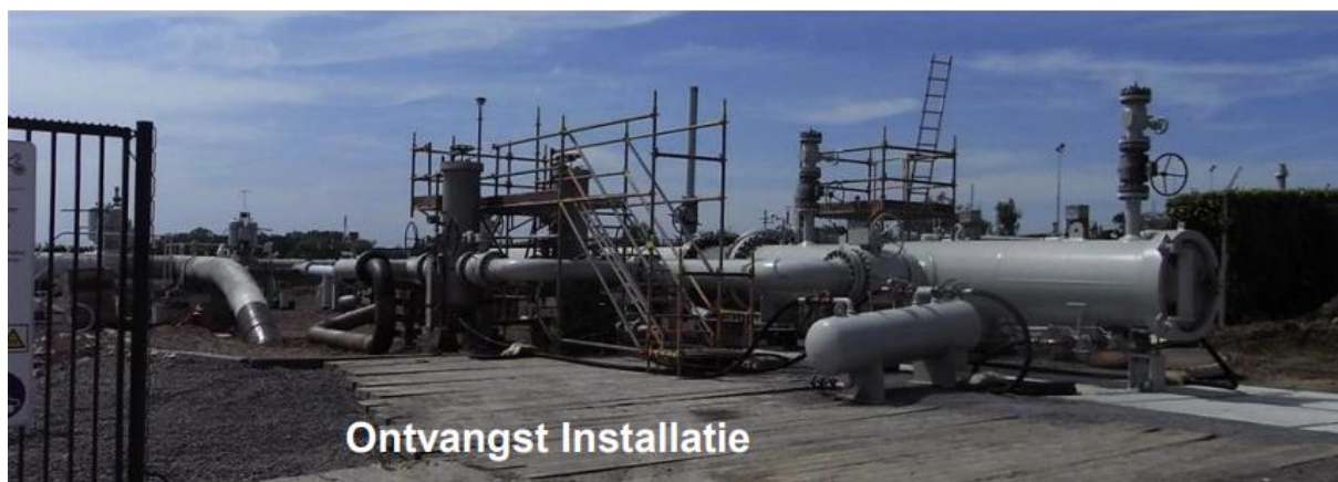
Figuur 5-19: Voorbeeld pigging ontvangststation (1)
