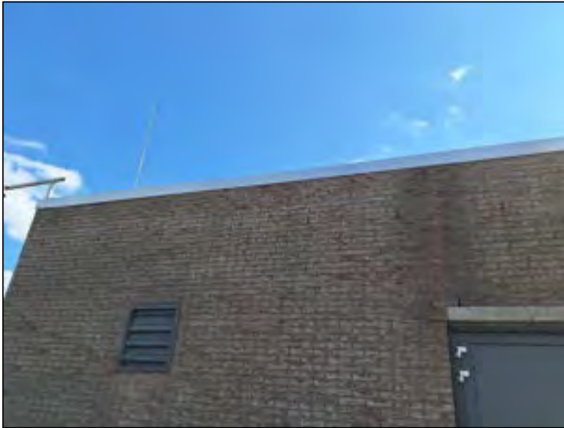
Figuur 2.2. Kieren in de gevels in de bebouwing op CS Beverwijk S-545 die vleermuizen mogelijk toegang bieden tot de spouw.
