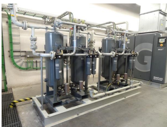
foto 1: Instrument Air room gebouw 01G
