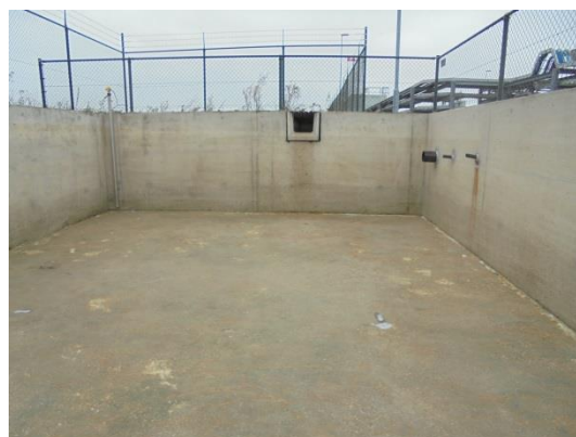
foto 2: Vuilwaterput / calamiteitenbak verharding
