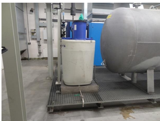
foto 1: Purge Air room
