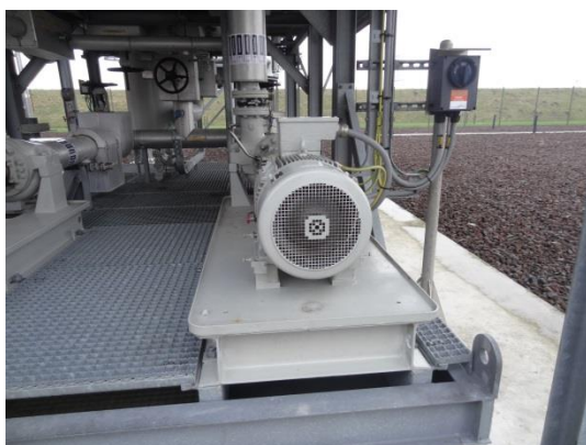
foto 1: Pompen t.b.v. koelwatersysteem
