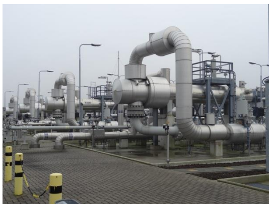
foto 1: Gas Heating Area (Warmte straat)
