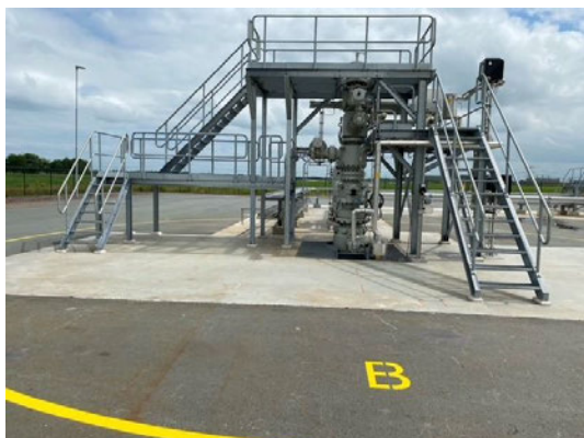
foto 1: Well Head gasproductie/injectie caverne A1
