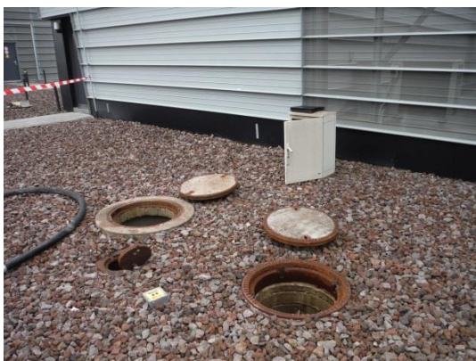
foto 1: Olie-water-scheider, inspectieput en pompput (foto uit 2014)
