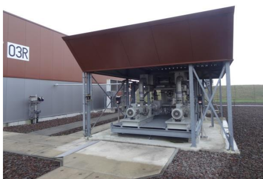
foto 1: Pompen met leidingwerk bij koelwaterskids
