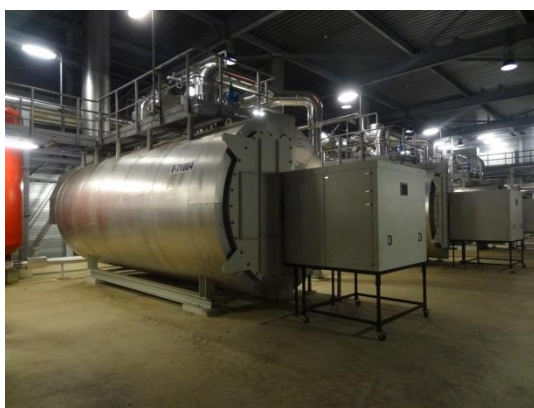
foto 1: Leidingtransport bij boiler
