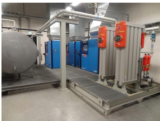
foto 1: Purge Air room
