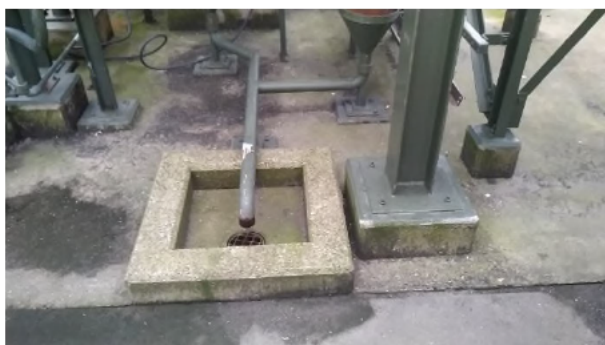
Fotonummer: 3 Omschrijving: Voorziening betonvloer met opstaande randen en afvoerpunt.
