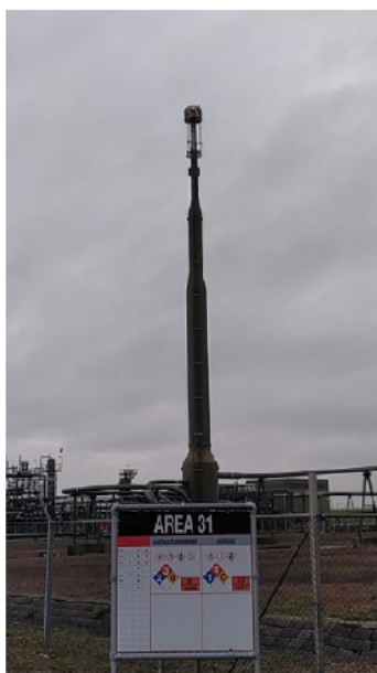
Fotonummer: 3 Omschrijving: Affakelinstallatie.
