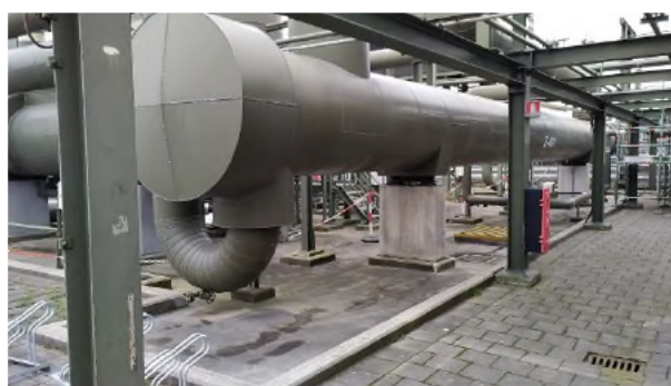
Fotonummer: 4 Omschrijving: Onderdelen procesinstallatie op een betonvloer met opstaande randen.
