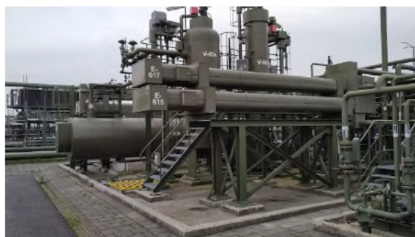
Fotonummer: 2 Omschrijving: Onderdelen procesinstallatie op een betonvloer met opstaande randen.
