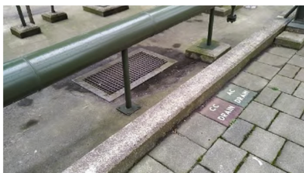
Fotonummer: 3 Omschrijving: Afvoerpunt met aanduiding CC drain en AC drain.
