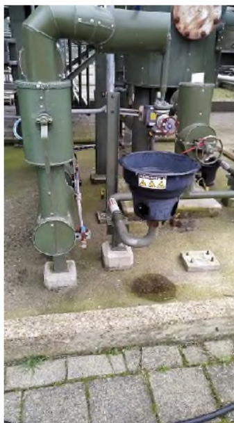
Fotonummer: 2 Omschrijving: Onderdelen procesinstallatie op een betonvloer met opstaande randen.
