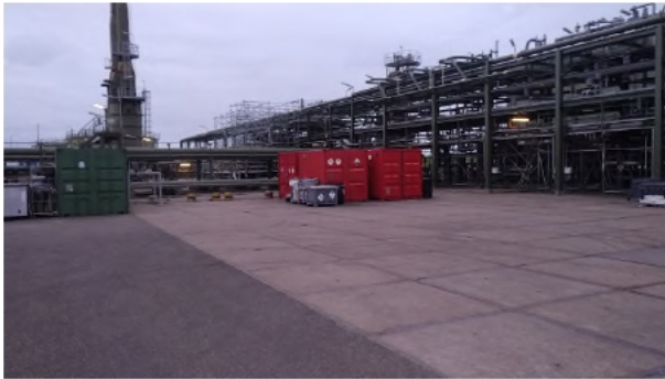
Fotonummer: 1 Omschrijving: Onderdelen installatie op betonvloer.
