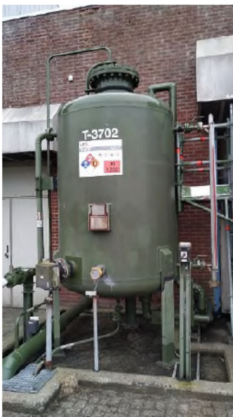
Fotonummer: 3 Omschrijving: Opstelling dieselolie vat.
