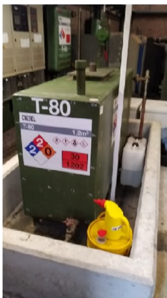
Fotonummer: 3 Omschrijving: Opslagtank diesel in pomphuis.
