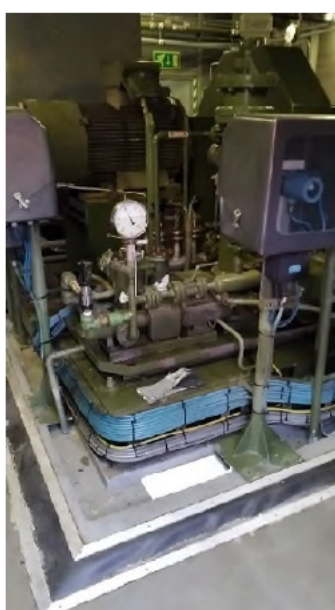
Fotonummer: 4 Omschrijving: Onderdelen procesinstallatie opgesteld op een betonvloer met opstaande randen.
