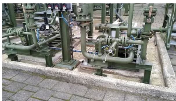
Fotonummer: 3 Omschrijving: Onderdelen procesinstallatie op een betonvloer met opstaande randen.
