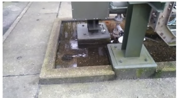
Fotonummer: 4 Omschrijving: Betonvloer met opstaande randen en verstopt afvoerpunt.
