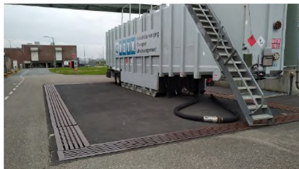
Fotonummer: 2 Omschrijving: Opstelplaats opslagcontainer industrieel reinigingswater.
