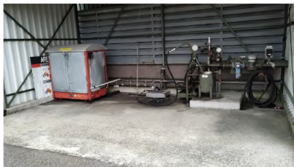
Fotonummer: 2 Omschrijving: Opslagruimte olie en bovengronds leidingwerk.
