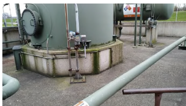
Fotonummer: 4 Omschrijving: Opgesteld vat op betonnen sokkel.
