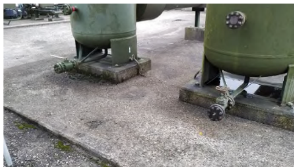
Fotonummer: 2 Omschrijving: Onderdelen installatie op betonvloer. Let op gebruik lekbakken onder afsluiters in geval van onderhoud.
