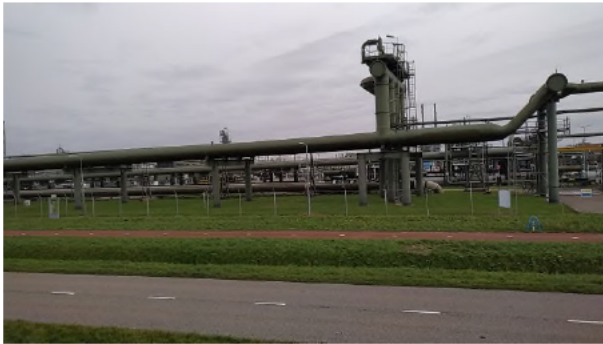
Fotonummer: 1 Omschrijving: Transportleidingen HiCal, LoCal en NOGAT.
