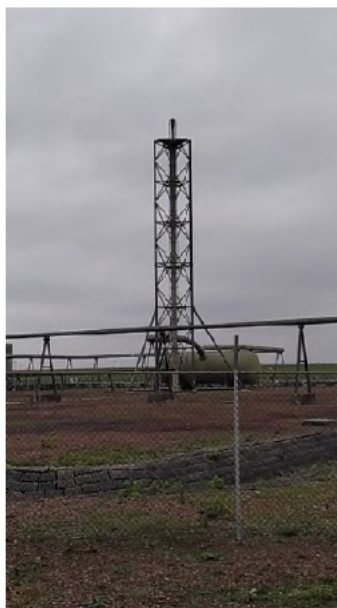
Fotonummer: 2 Omschrijving: Affakel installatie.
