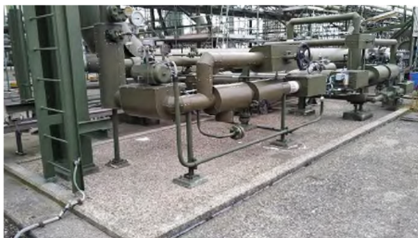
Fotonummer: 1 Omschrijving: Onderdelen installatie op betonvloer.
