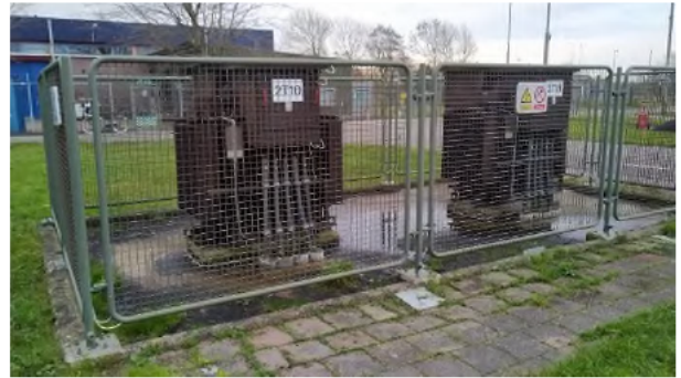
Fotonummer: 2 Omschrijving: Buiten opgestelde transformatoren.
