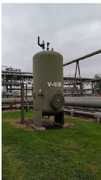
Fotonummer: 3 Omschrijving: Opslag vat V-630.
