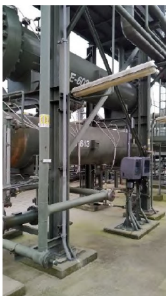
Fotonummer: 3 Omschrijving: Onderdelen procesinstallatie op een betonvloer met opstaande randen en diverse ondersabelingen.
