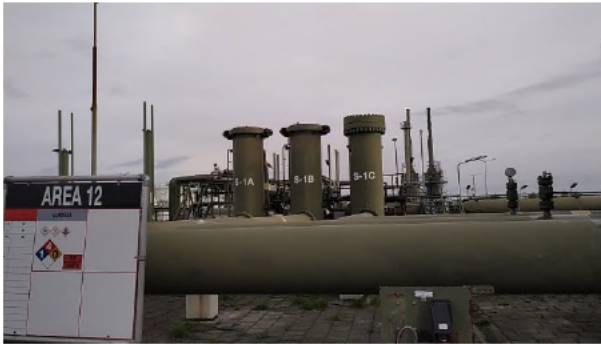
Fotonummer: 1 Omschrijving: Ontvangstinstallatie HiCal.
