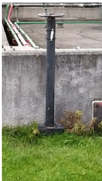
Fotonummer: 3 Omschrijving: Voorbeeldfoto afsluiter.
