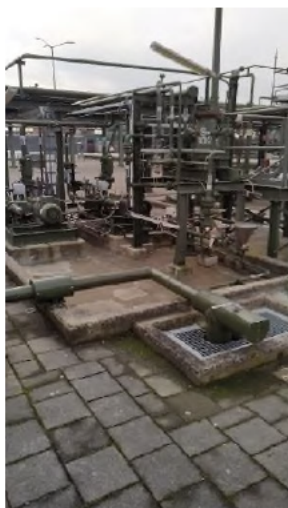
Fotonummer: 3 Omschrijving: Onderdelen procesinstallatie op een betonvloer met opstaande randen. Aansluiting op drain verzamelleiding.
