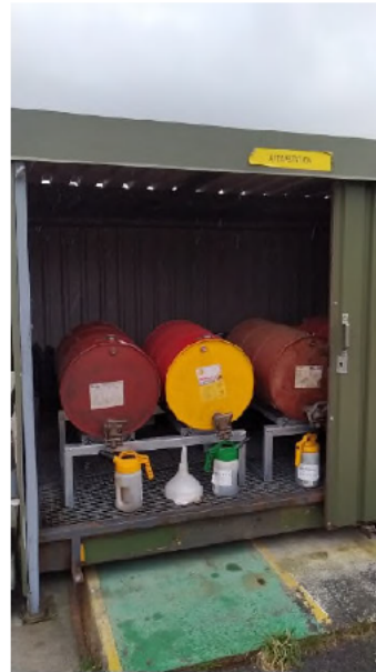
Fotonummer: 2 Omschrijving: Opslag vaten voor aftapwerkzaamheden in opslag met lekbakken.
