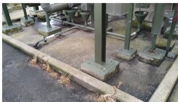
Fotonummer: 4 Omschrijving: Voorziening betonvloer met opstaande randen en afvoerpunt.
