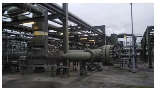
Fotonummer: 4 Omschrijving: Installatie onderdelen geplaatst op een betonvloer.
