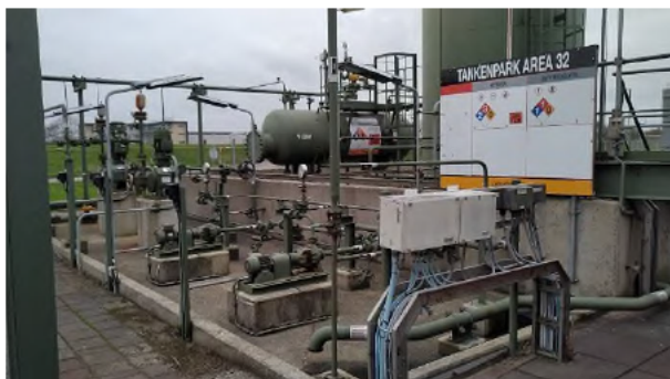
Fotonummer: 1 Omschrijving: Aanduiding area 32 en opgestelde procesapparatuur op betonvloer met opstaande randen.
