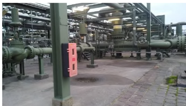
Fotonummer: 2 Omschrijving: Installatie onderdelen geplaatst op een betonvloer.
