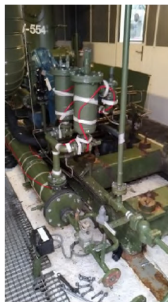
Fotonummer: 2 Omschrijving: Voorbeeldfoto procesinstallatie met goed gebruik absorptiematerialen.
