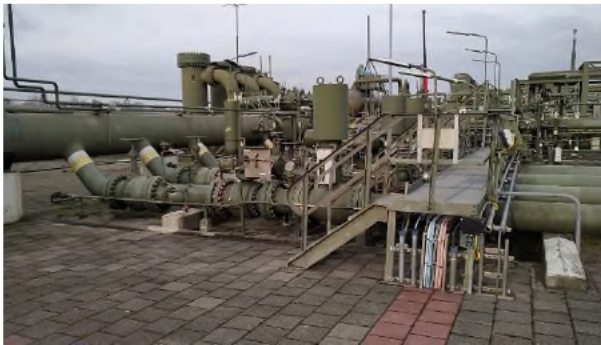
Fotonummer: 3 Omschrijving: Ontvangstinstallatie HiCal.
