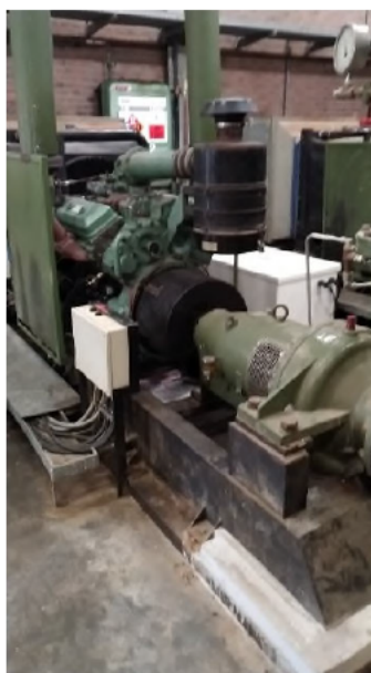
Fotonummer: 4 Omschrijving: Pompopstelling in pomphuis.
