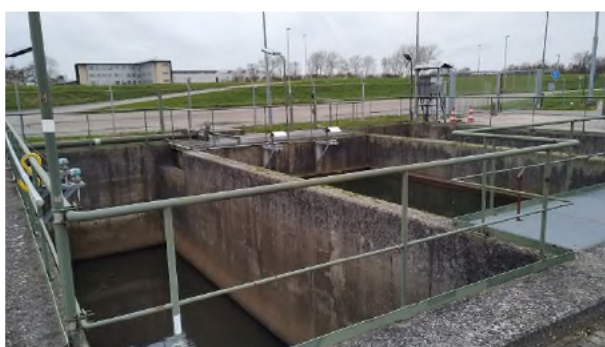
Fotonummer: 3 Omschrijving: Opvangbak voor regen- en AC water.
