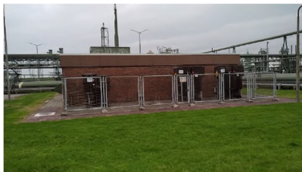
Fotonummer: 2 Omschrijving: Locatie met drie transformatoren.
