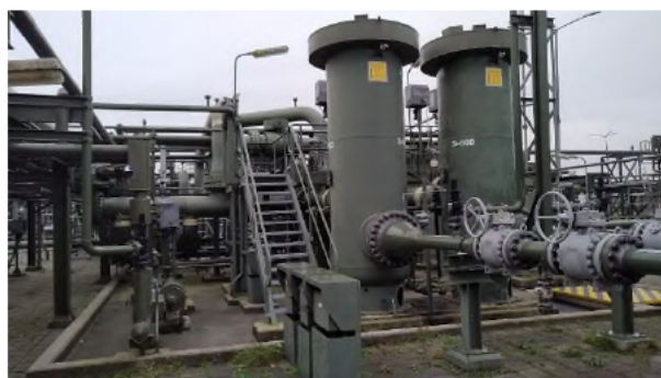
Fotonummer: 2 Omschrijving: Onderdelen procesinstallatie opgesteld op een betonvloer met opstaande randen.
