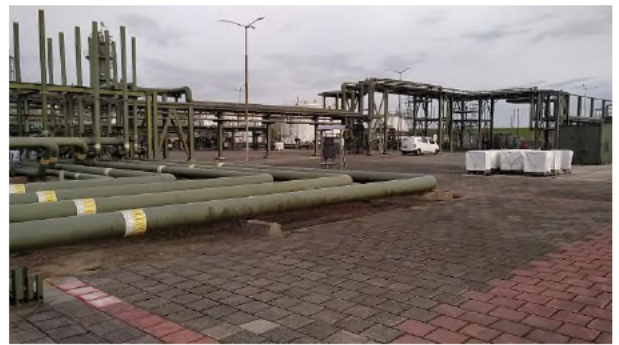
Fotonummer: 4 Omschrijving: Bovengronds leidingwerk HiCal.
