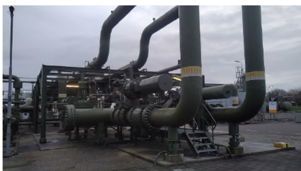
Fotonummer: 3 Omschrijving: Installatie onderdelen geplaatst op een betonvloer.
