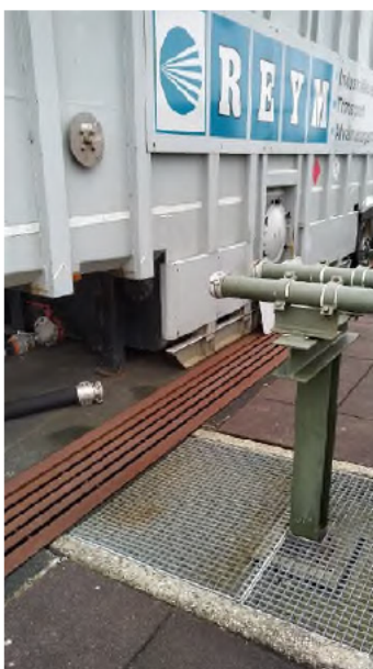
Fotonummer: 5 Omschrijving: Aansluitpunten/ koppelingen zuigslangen reinigingswagens.
