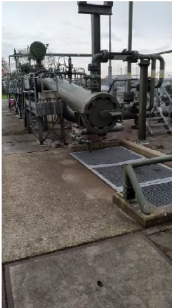
Fotonummer: 1 Omschrijving: Scraper ontvangstinrichting.
