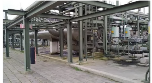
Fotonummer: 2 Omschrijving: Onderdelen procesinstallatie op een betonvloer met opstaande randen.
