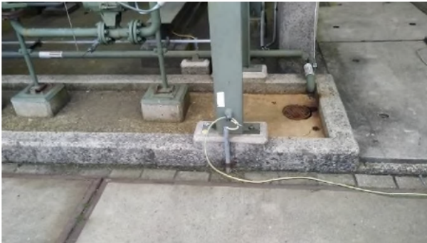
Fotonummer: 1 Omschrijving: Alle onderdelen van de installatie geplaatst op betonvloeren welke als vloeistofkerend worden beschouwd.
