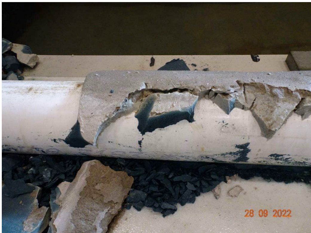
Figuur 4.3 Uitgetrokken leiding waar een deel van de Drill-Grout plug van af is gevallen.
