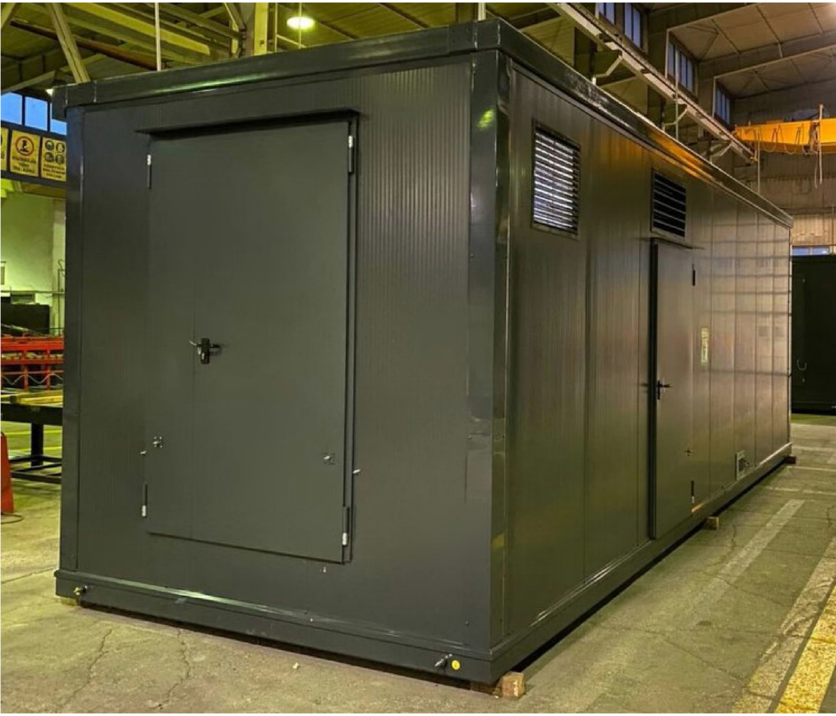
SUBSTATION ZOALS REEDS GEBOUWD
