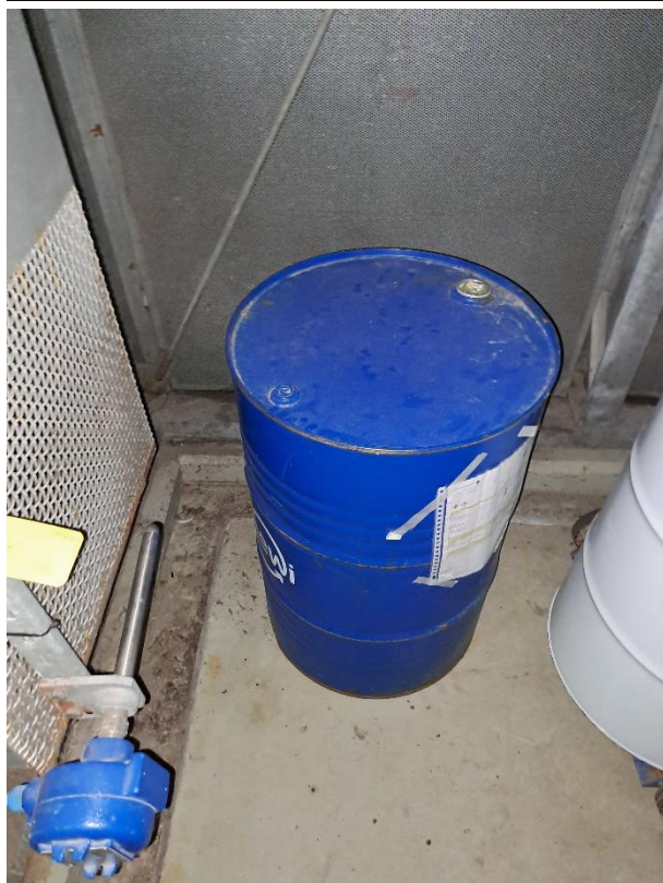
Objectnr. 99 Emballage in compressor gebouw K-170
