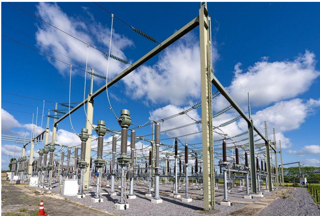
Afbeelding 2: Foto voorbeeld hoogspanningsstation
