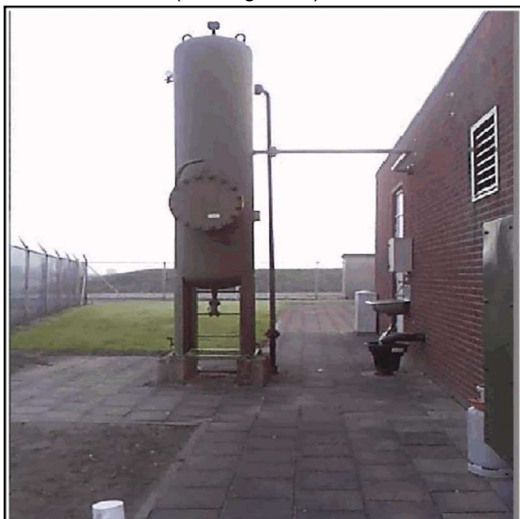
ObjectNr: 57 Bedrijfsactiviteit: V-20 Instrumentluchtbuffervat (buiten gebruik)
