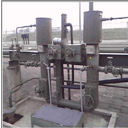
ObjectNr: 41 Bedrijfsactiviteit: S-4A Glycolfilter (buiten gebruik)
