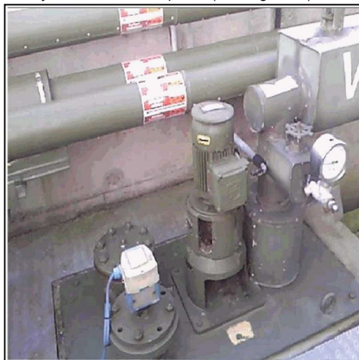
ObjectNr: 11 Bedrijfsactiviteit: P-9 Drainpomp (buiten gebruik)
