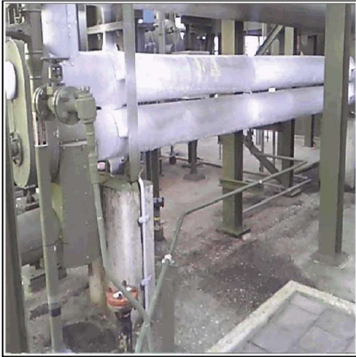
ObjectNr: 36 Bedrijfsactiviteit: E-4 Glycol/condensaat Warmtewisselaar (buiten gebruik)
