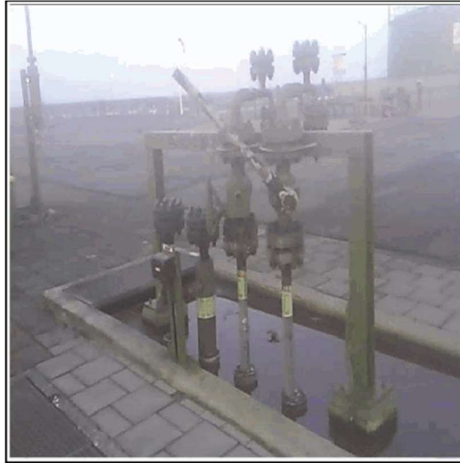
ObjectNr: 08 Bedrijfsactiviteit: Doodpompaansluiting (buiten gebruik)
