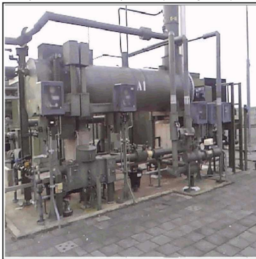
ObjectNr: 45 Bedrijfsactiviteit: A-1 Glycolregenerator (buiten gebruik)
