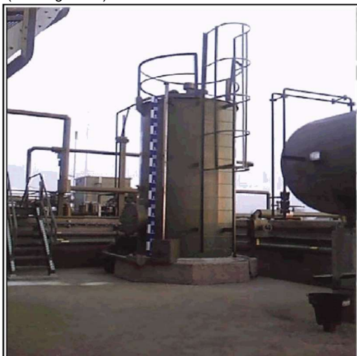
ObjectNr: 16 Bedrijfsactiviteit: T-2 Anti-corrosievloeistof opslagtank (buiten gebruik)
