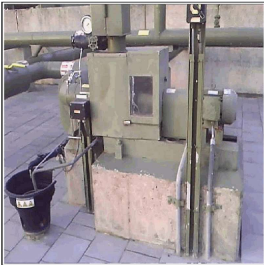
ObjectNr: 18 Bedrijfsactiviteit: P-3B Water/aardgascondensaat verlaadpomp (buiten gebruik)
