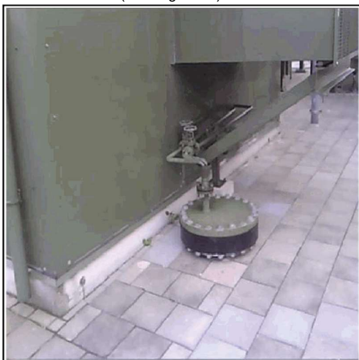
ObjectNr: 51 Bedrijfsactiviteit: Drainput afgascompressor (buiten gebruik)
