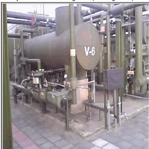
ObjectNr: 34 Bedrijfsactiviteit: V-6 Water/glycol/aardgascondensaatscheider (buiten gebruik)
