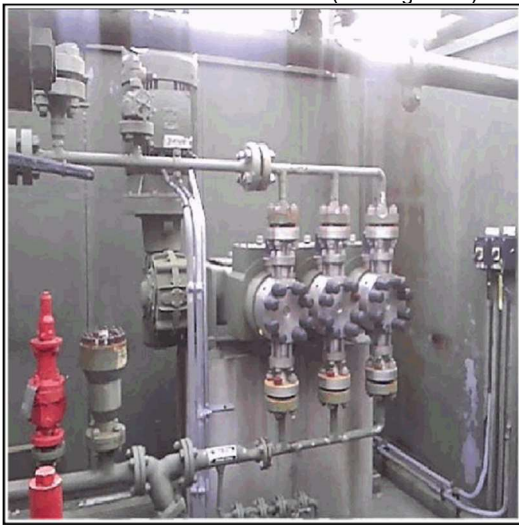
ObjectNr: 38 Bedrijfsactiviteit: P-6B Glycol injectiepomp (buiten gebruik)
