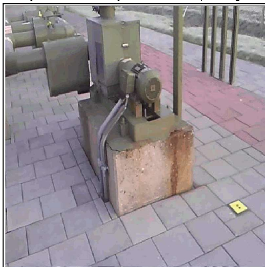
ObjectNr: 17 Bedrijfsactiviteit: P-3A Water/aardgascondensaat verlaadpomp (buiten gebruik)
