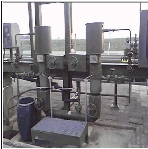
ObjectNr: 43 Bedrijfsactiviteit: S-2A Glycolfilter (buiten gebruik)
