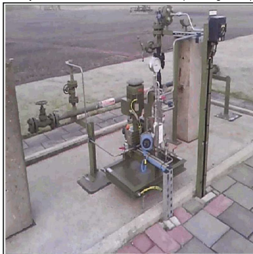
ObjectNr: 23 Bedrijfsactiviteit: P-2-2 Anti-corrosievloeistofpomp (buiten gebruik)
