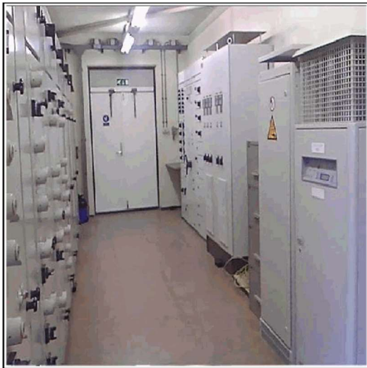
ObjectNr: 53 Bedrijfsactiviteit: Laagspanningsruimte
