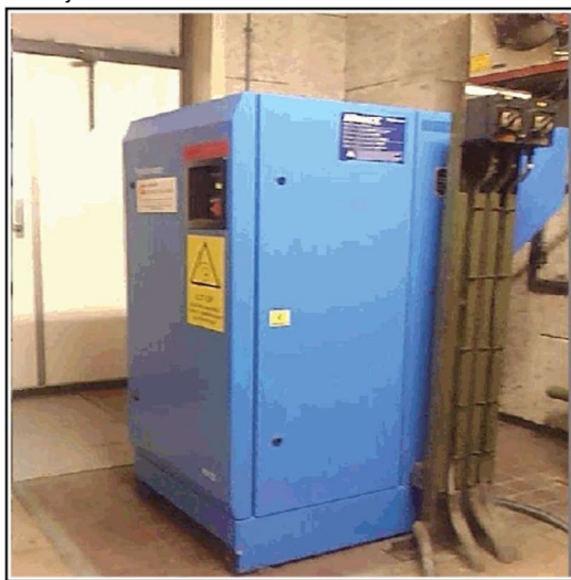
ObjectNr: 56 Bedrijfsactiviteit: K-1B Luchtcompressor (buiten gebruik)
