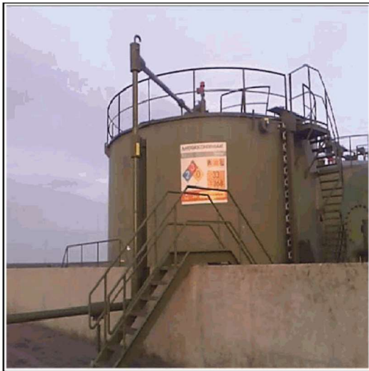
ObjectNr: 12 Bedrijfsactiviteit: T-1 Water/aardgascondensaat opslagtank (buiten gebruik)
